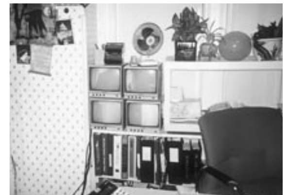
アメリカのDVシェルター。侵入者を防ぐため、事務室に設置された監視カメラ。
